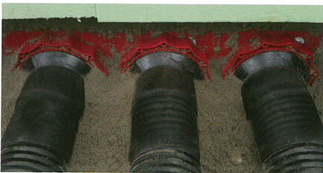
コールドシュリンクによるコルゲートパイプ接続例 (HSI 150-D 110-KS)
